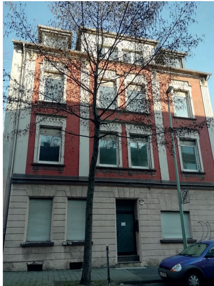
Abb. 25: Für unbewohnbar erklärtes Gebäude in Duisburg
