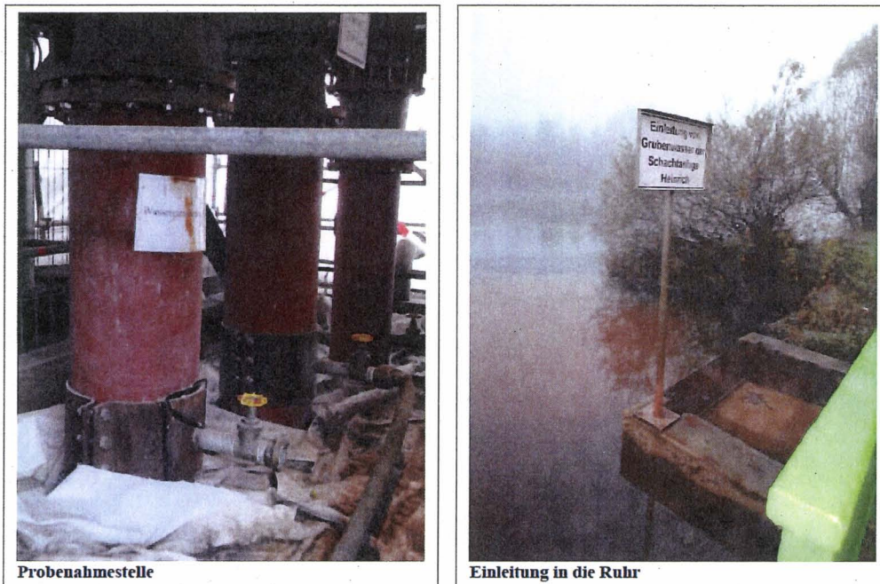
Abbildung 8: Grubenwassermessstelle und Einleitung Zeche Heinrich, Foto RAG
